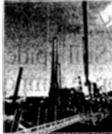
La piattaforma di Tap nel porto di Brindisi
