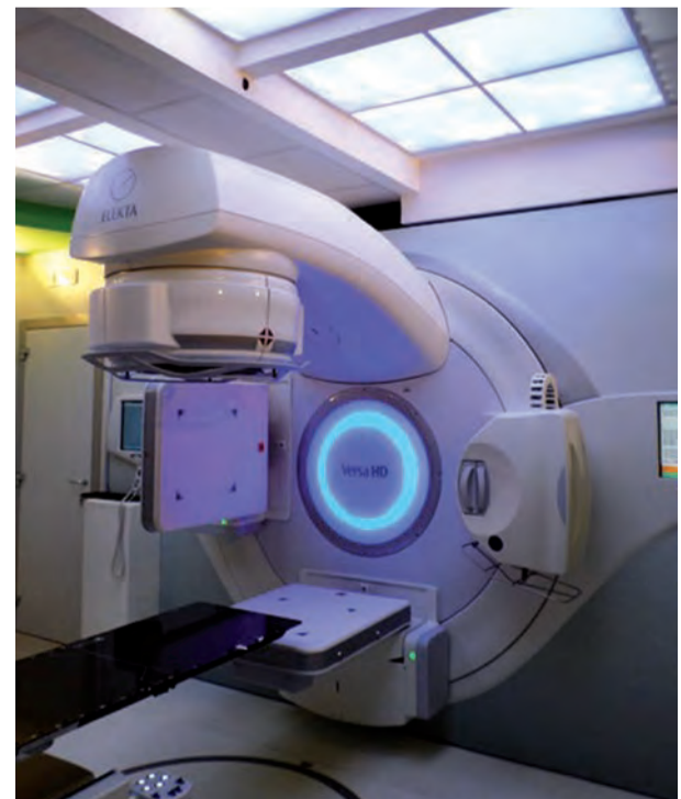
Linac Elekta Versa, apparecchiatura radioterapica di ultimissima generazione, la prima installata in Italia e tra le prime in Europa
